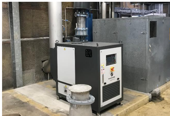
Blåsmaskin på reningsverket i Osby
