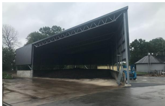
Osby ARV; Taket över slamplattan. Detta kommer medföra ett torrare slam vilket leder till mindre transporter och lägre avsättningskostnad.
