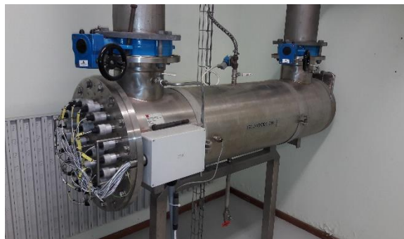
UV-ljus, Olofström vattenverk
