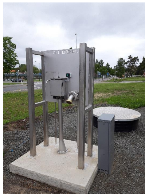
Vattenkiosk vid Bromölla vattenverk
