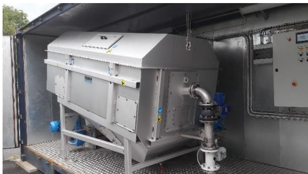
Externslammottagning, Bromölla reningsverk
