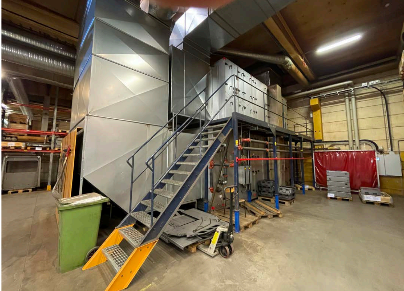
Bytet av två halvstora ventilationsaggregat till ett stort frekvensstyrt aggregat har förbättrat energieffektiviteten väsentligt.
