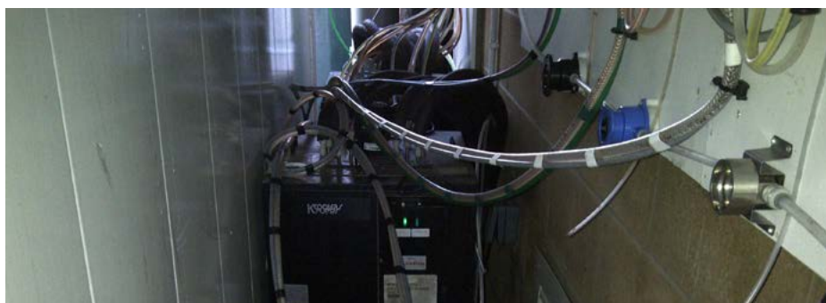
Circuit de refroidissement de boissons à la pression laissé en marche pendant de longues périodes d'inutilisation.
