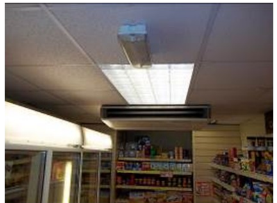
Ursprüngliche Anlage und neuer Abluftventilator
