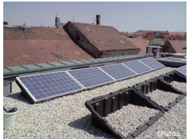
Photovoltaikanlage auf dem Dach
