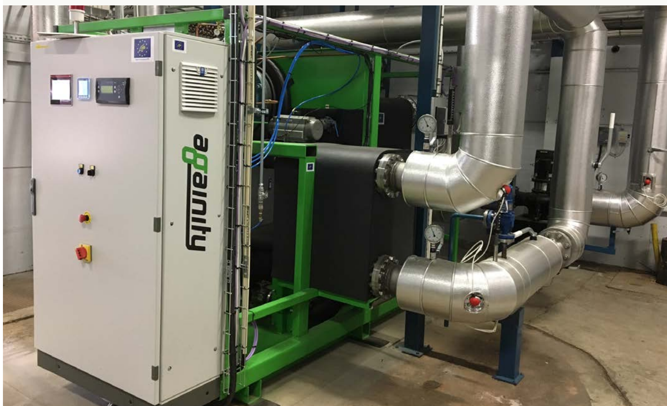
Organisk Rankinecykel (ORC) - teknik för småskalig kraftvärme. Foto: Johanna Wallin
