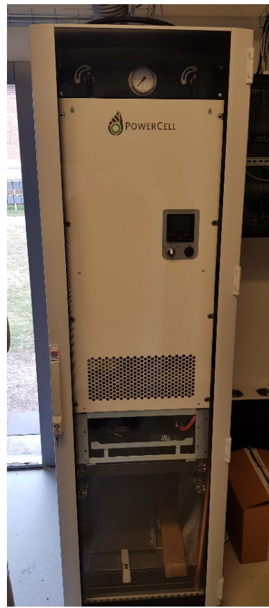
Figur 3. Bränslecellen installerad i Vårgårda.
