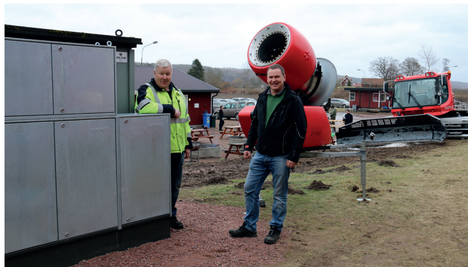
Dan Orvegren från Olofströms Kraft och Sven Holmer, elansvarig för Vångabacken, bredvid backens egen transformatorstation.
