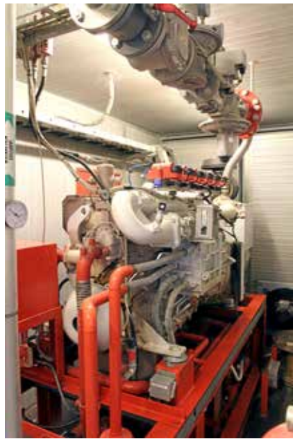
En 6-cylindrig MAN-motor på 600 kW driver en generator på 190 kW. En utnyttjandegrad på 97 % i snitt innebär att motorn producerar el hela tiden, i stort sett utan avbrott. Sivert Edvardsson sköter tillsyn, filter- och oljebytan. Motorn servas var tusende timme av en dansk firma.
