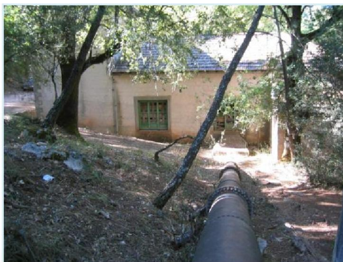
Picture 13. Penstock. Cerrada de Utrero SHP. Jaén.
