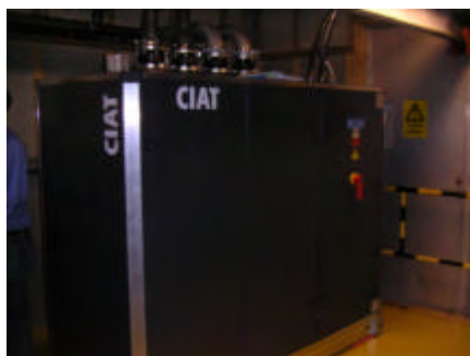
Värmepump med plattvärmeväxlare
