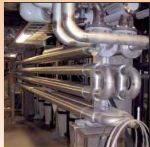
Avloppsvärmeväxlare för återvinning av värme från duschvattnet.
