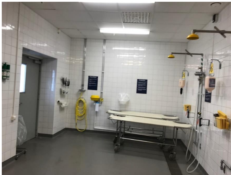
Figur 9: Bild på saneringsenhet. Rummet har fyra duschar varav två syns på bilden. I denna saneringsenhet kan 2 liggande alternativt 4 gående patienter saneras samtidigt. Saneringsenheten ligger mot ytterväggen i ambulanshallen och patienter kommer in direkt i saneringsrummet, där sker avklädning och personsanering. Därefter kommer rena patienter till slussen och efter att de blivit torkade och fått rena kläder fortsätter de genom ambulanshallen och in på akutmottagningen för fortsatt omhändertagande
